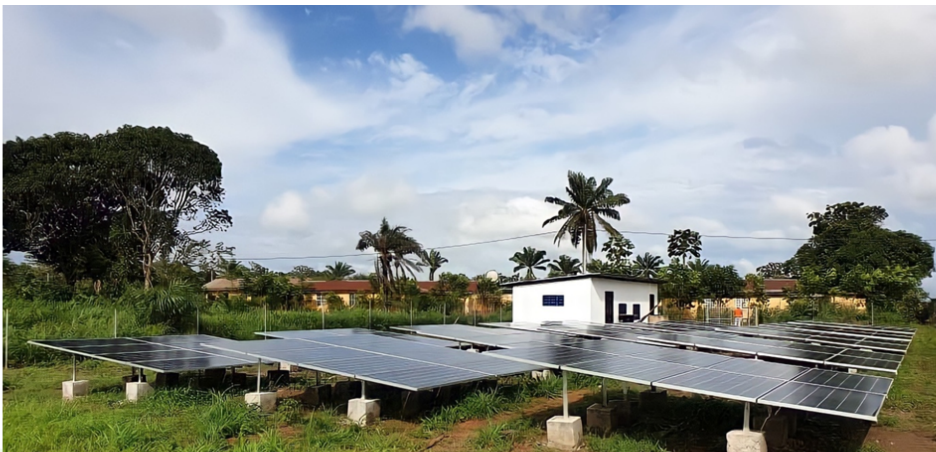
Mini-réseau du site de Hontonou- Commune de Aplahoué (Promoteur Energicity, projet Wéziza Bénin)
