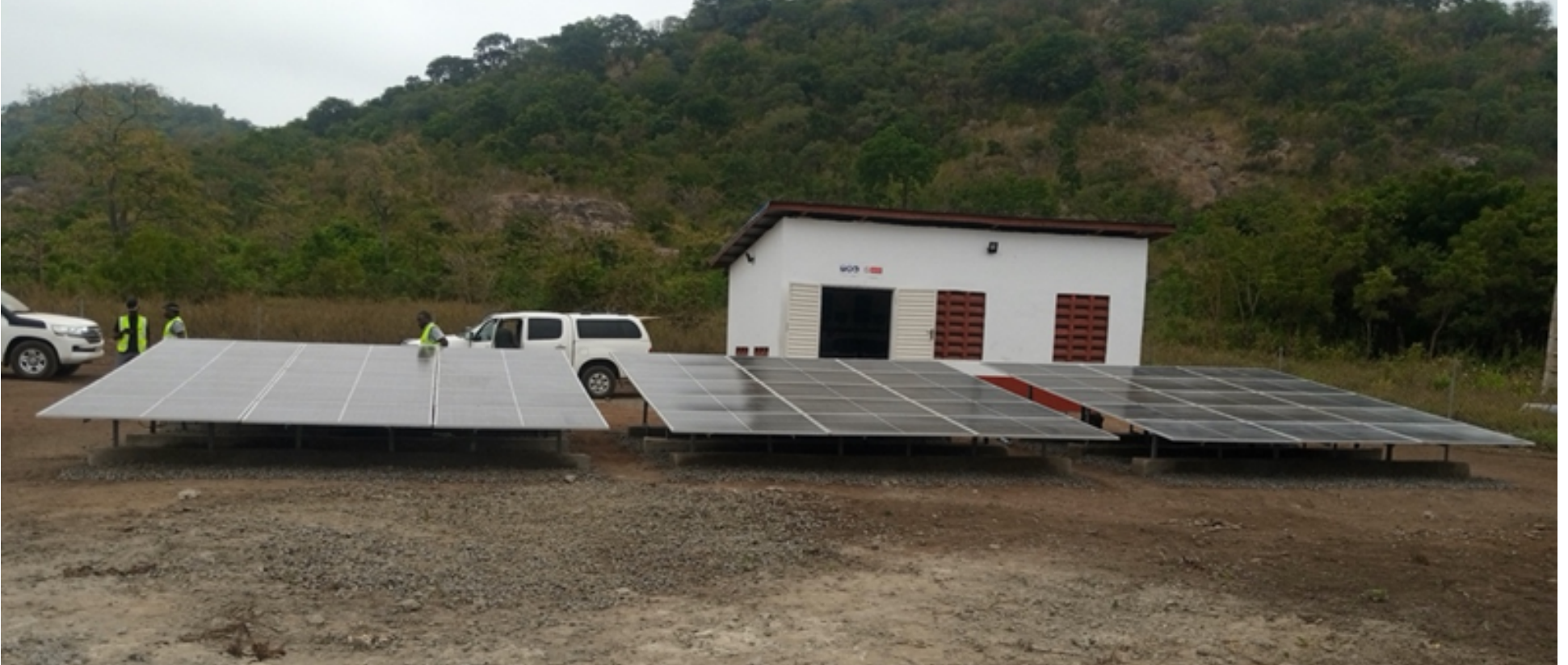
Mini-réseau du site de Zouto Atchéribé - Commune de Dassa Zoumè (Promoteur Energicity, projet Wéziza Bénin)
