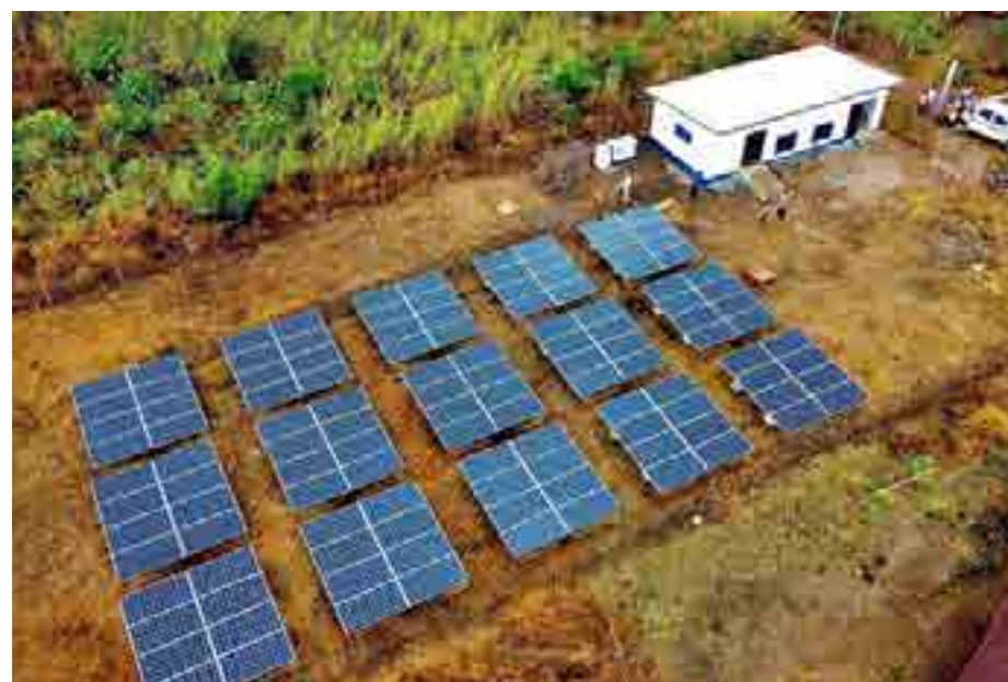
Mini-réseau du site Gougouta - Commune de Applahoué (Promoteur Enercity, projet Wéziza Bénin)
