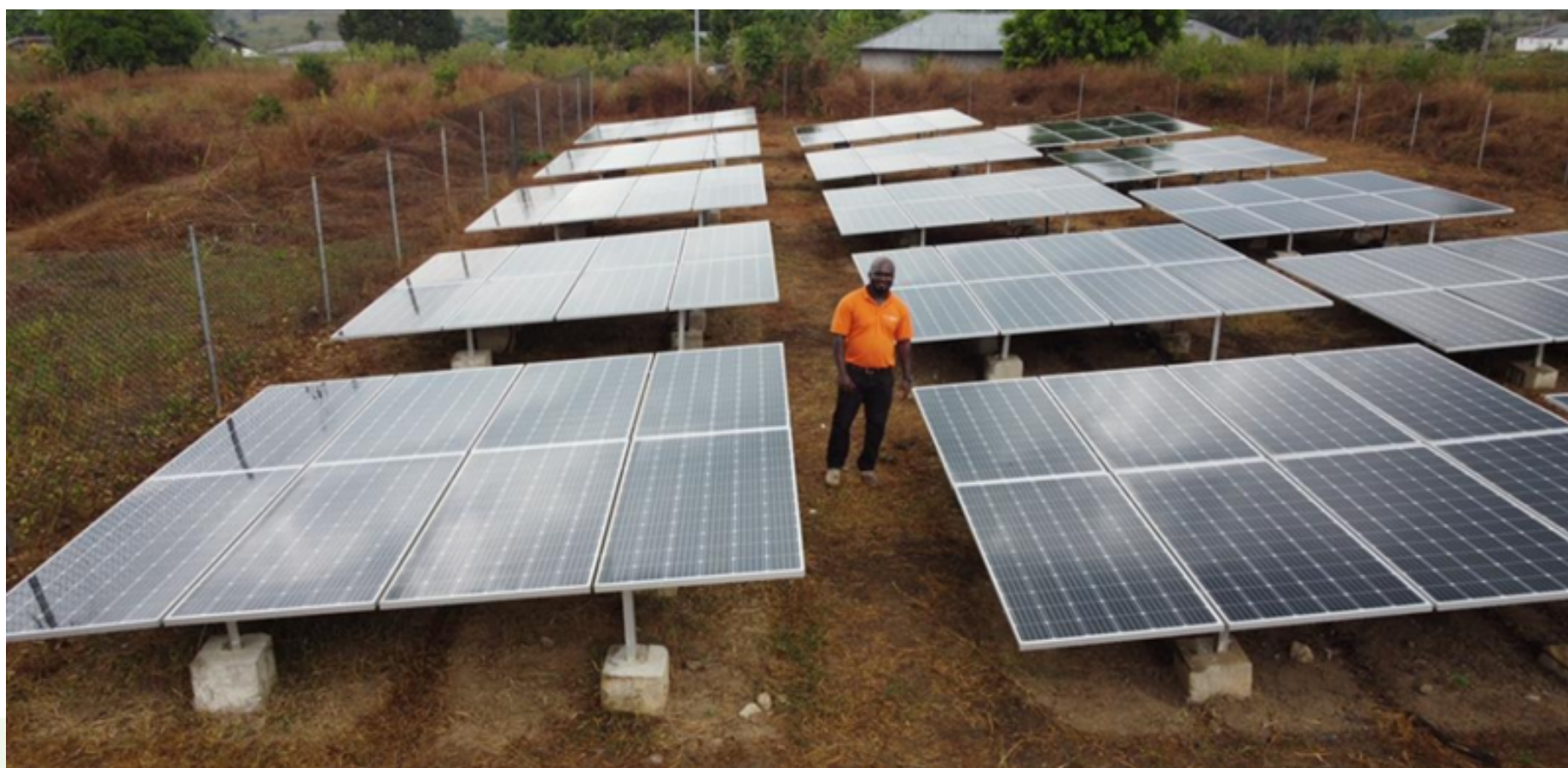
Mini-réseau du site de Gounsoé dans Paouignan - Commune de Dassa-Zoumè (Promoteur Energency, projet Wéziza Bénin)
