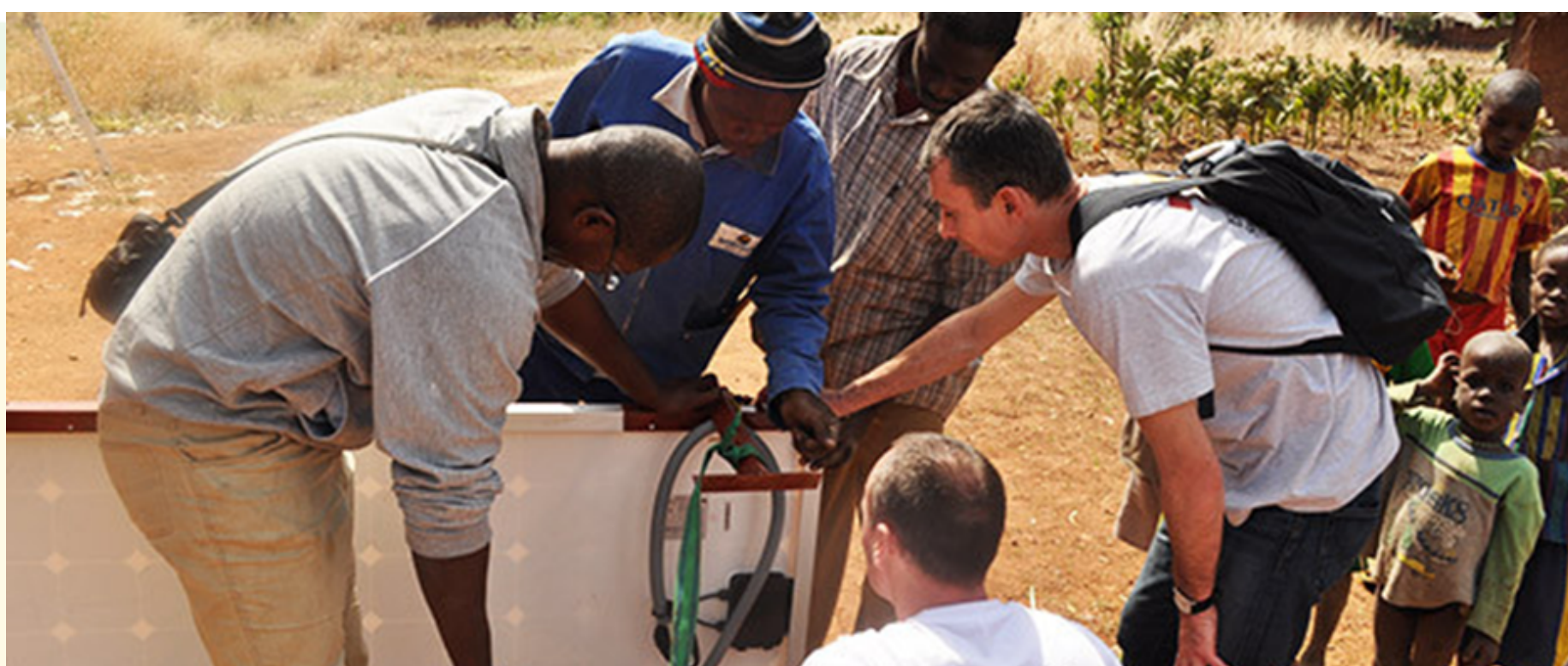
Vérification des caractéristiques du panneau à installer à Djèkpé avant installation Commune de So-Ava (Promoteur ESF - Électriciens Sans Frontières)
