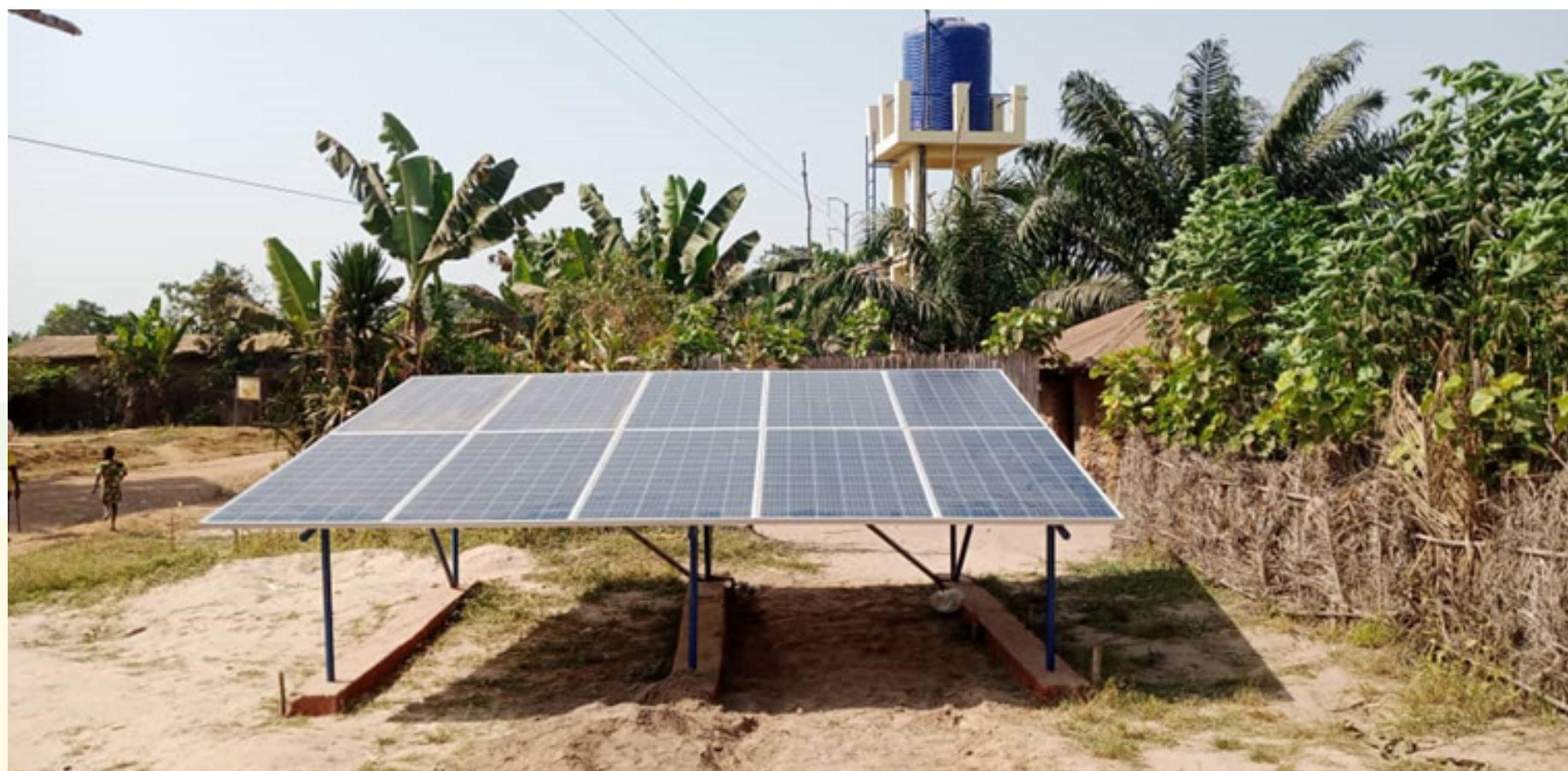
Générateur solaire pour le pompage au fil de l'eau de Zalimey - Commune de Zogbodomey (Promoteur ENERDAS)
